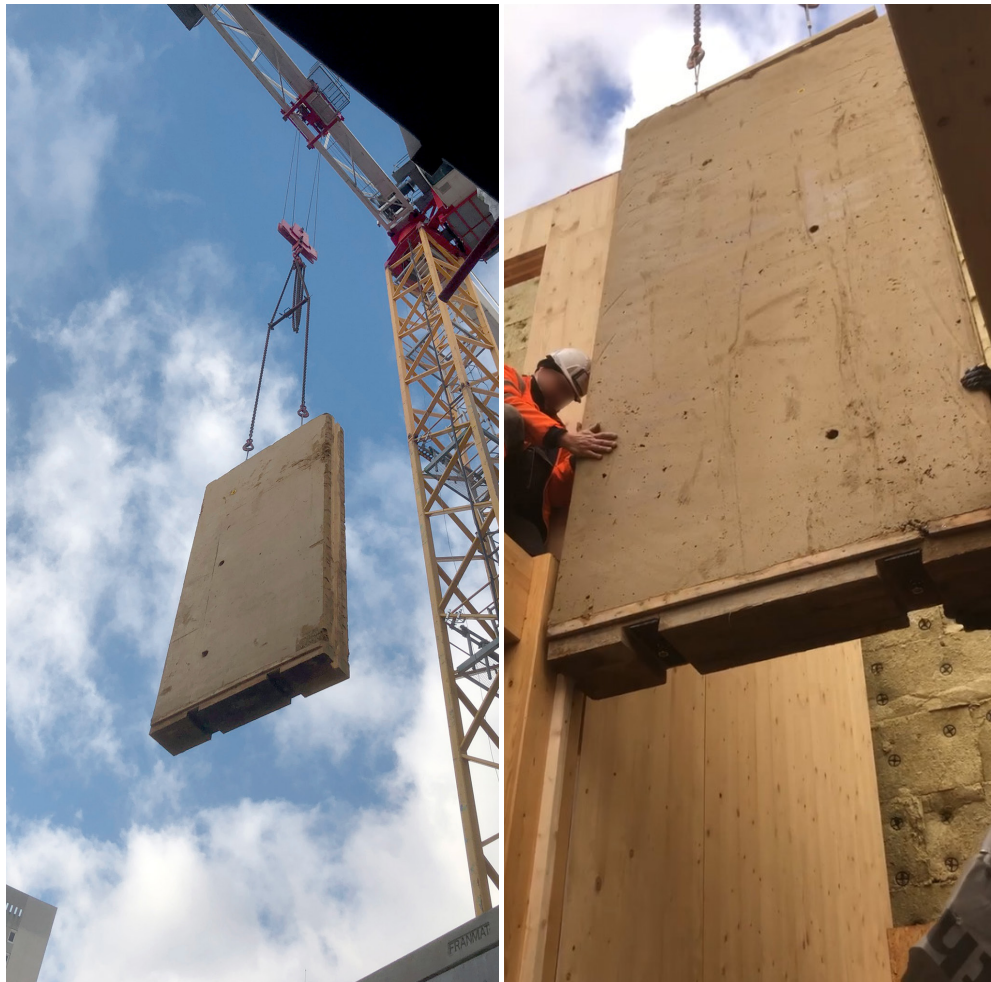
Mur en terre crue coulée levé par la grue (à gauche) ; Pose d'un mur en terre crue (à droite) - médiathèque James Baldwin, Paris 19e ©nm architecte
