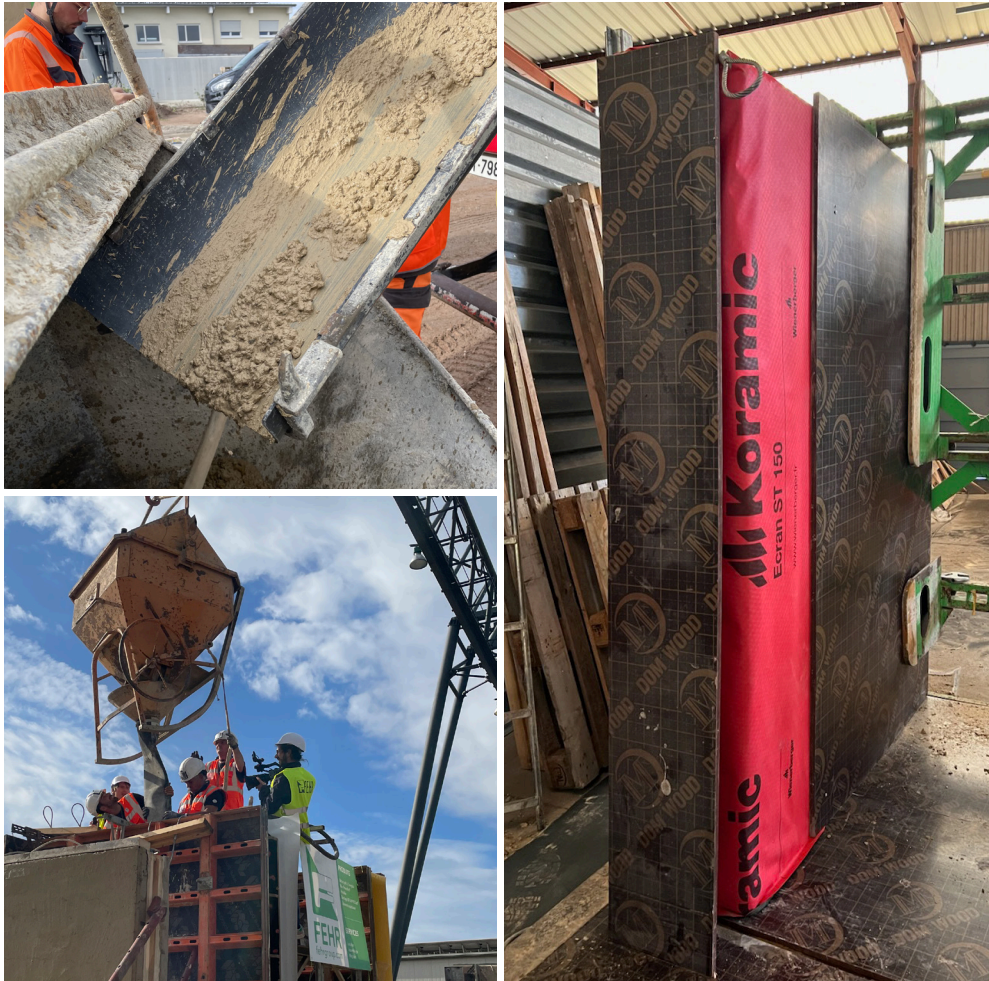
Béton d'argile (en haut à gauche) ; Coulage du béton d'argile dans un coffrage à béton de ciment (en bas à gauche) ; Mur en terre crue coulé emballé avec un pare-pluie, placé dans un rack de transport FEHR et sarcophage en contreplaqué en cours de pose (à droite) - usine FEHR, Achern, Allemagne ©nm architecte / FEHR Groupe
